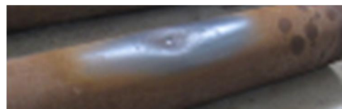
شکل 1 نمونه ای از فرورفتگی در لوله
